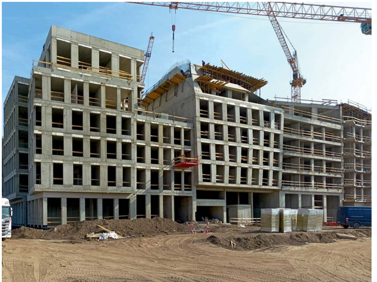
Stavba Smíchov City SM3 zahrnuje větrání v rezidenčním bloku devíti domů s 210 byty podél ulice Za Ženskými domovy.
