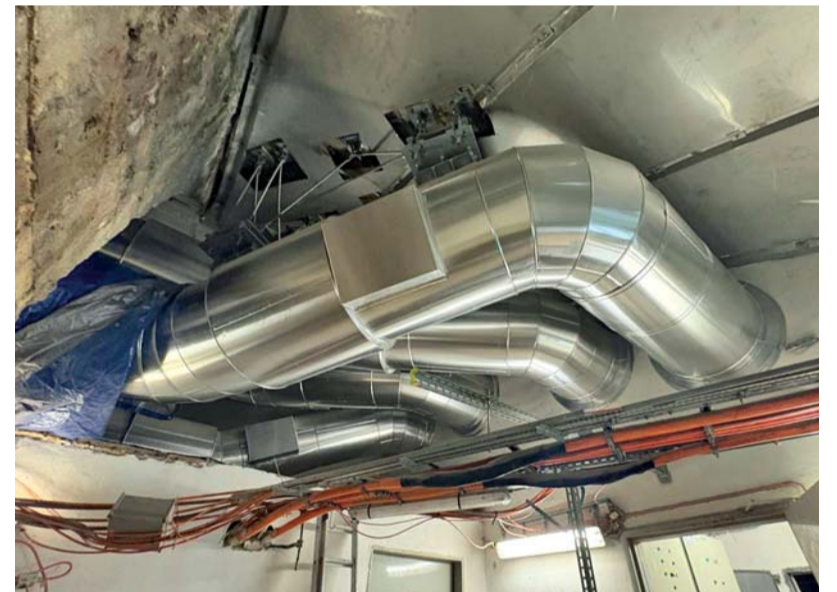
Vyvedení spalinovodu ze strojovny motorgenerátorů.
