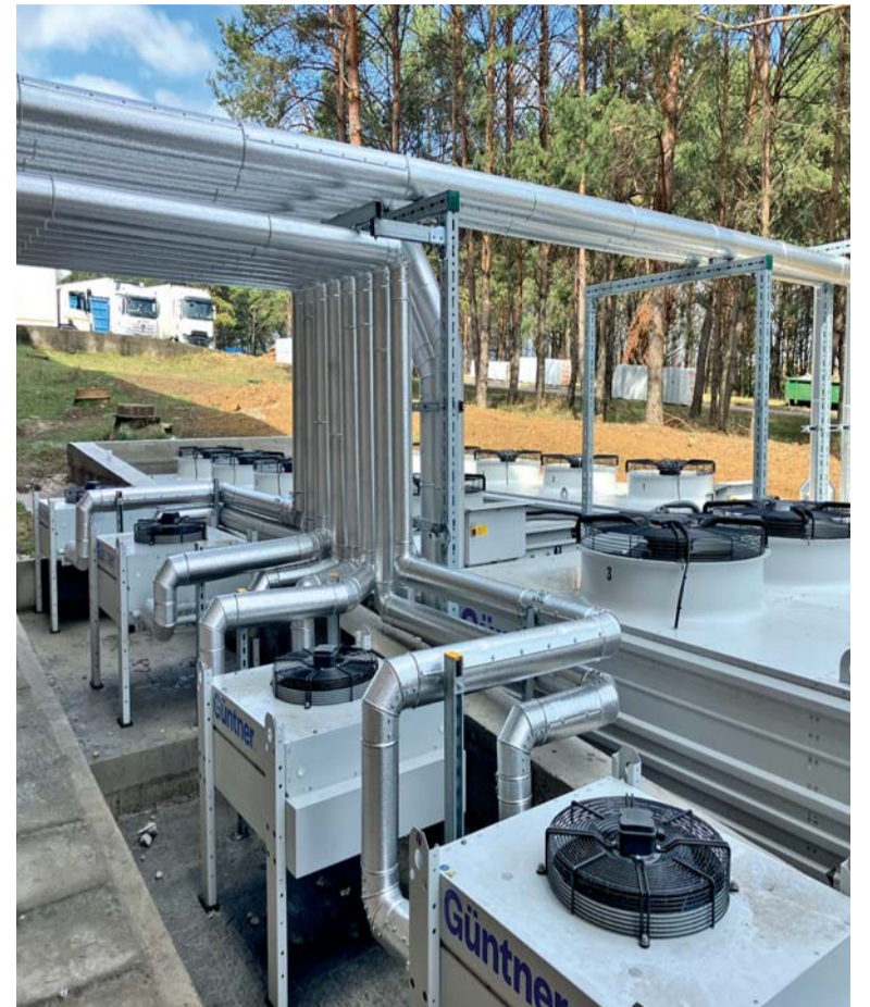
Vonkajšie jednotky kondenzátory – technológia mrazenia a chladenia.
